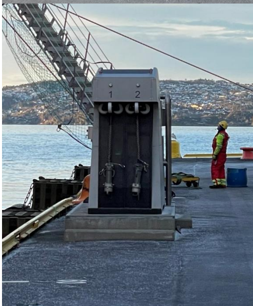
Typisk landstrøm tilkoblingspunkt på kaifront
